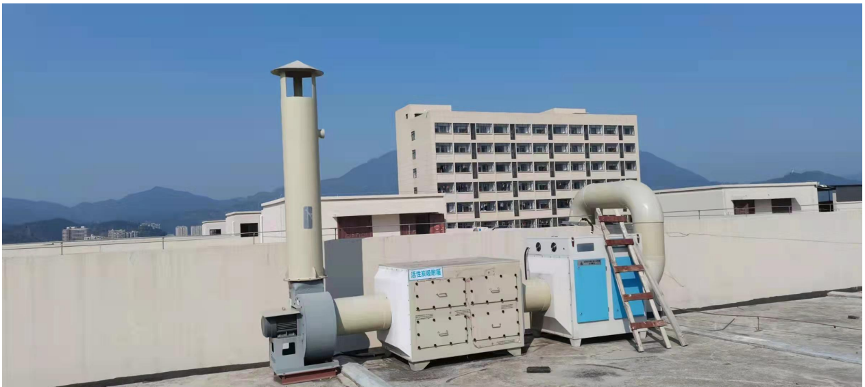
废气处理设施
